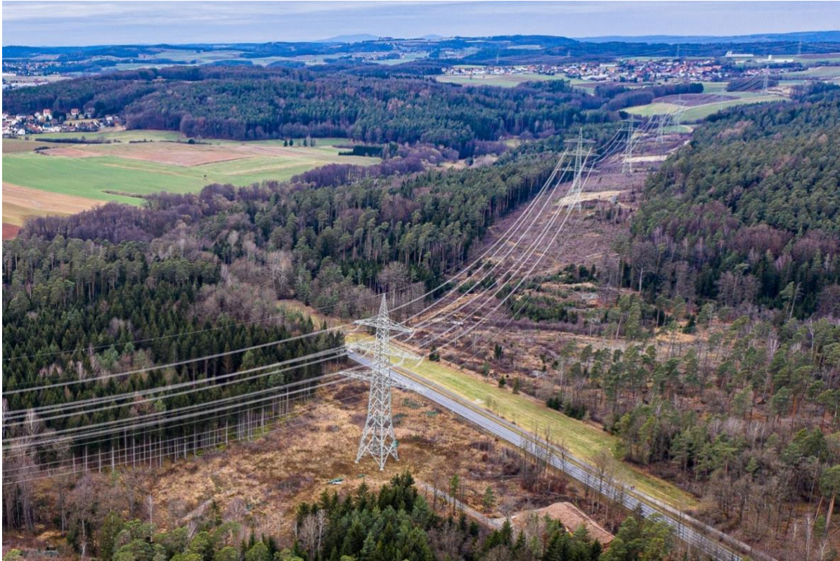
„Thüringer Strombrücke“ bei Sonnefeld in Oberfranken; Trassenbreite 100 m
